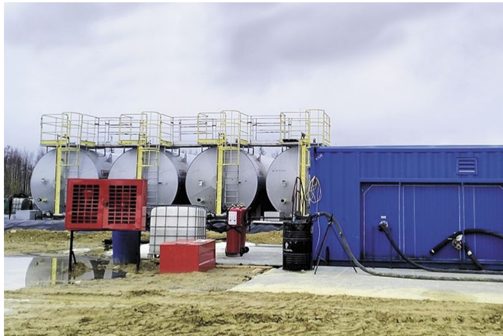
Парк горюче-смазочных материалов на Базе производственного обеспечения
