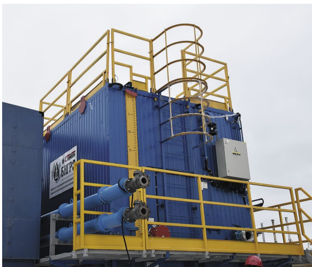
Модульная насосная станция пенного пожаротушения на ТК-79
