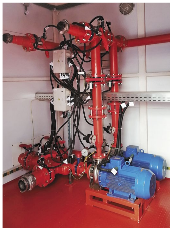
Центробежные насосы станции пенного пожаротушения
